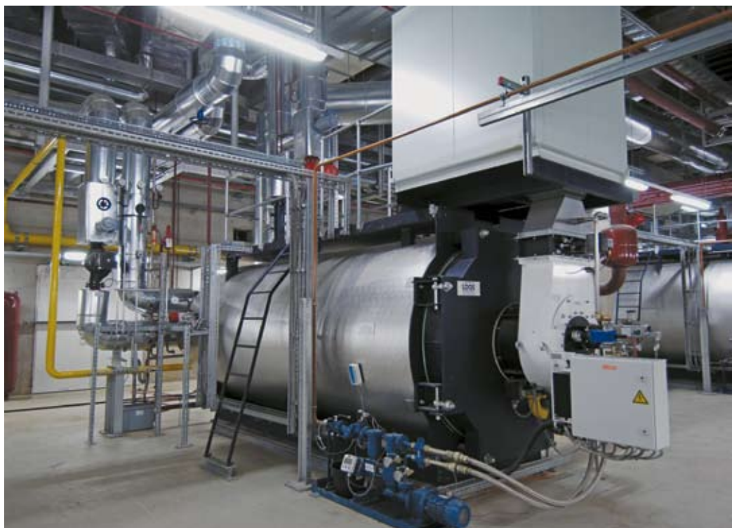
■ Das drehzahlgesteuerte Hochleistungsgebläse oberhalb des Kessels versorgt den Elco-Zweistoffbrenner mit genau dosierter Verbrennungsluft. Bild: Elco
